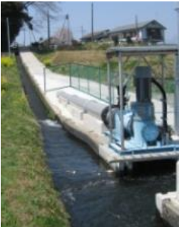
城原井路発電所(竹田市)
